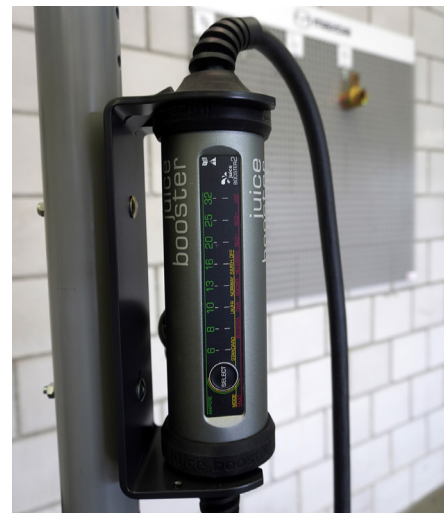
Fig. 1: per la ricarica dei veicoli elettrici si utilizzano trasformatori che funzionano con energia di rete sinusoidale. L'immagine mostra una scatola a muro di produzione svizzera.
